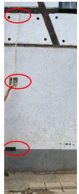
Hochwassermarken 1910, 1805 und 2021 von unten nach oben, Quelle: A. Fekete 2021
