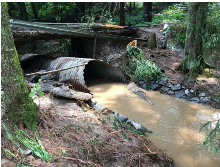
Abb. 7: Erosionsschäden und Ausspülungen am Gewässer aufgrund von Sturzfluten am Weltersbach
