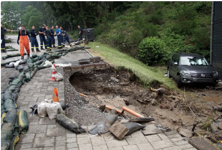
Abb. 6: Straßenschäden auf dem Gelände des Pilgerheims Weltersbach
