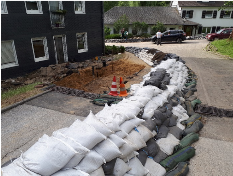
Abb. 10: Sofortmaßnahme am Pilgerheim Weltersbach
