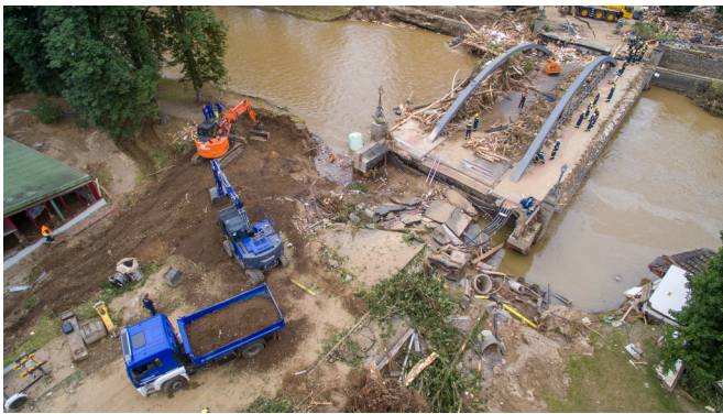
Hochwasserschäden im Ahrtal (Quelle: Lukas Hanning, THW)
