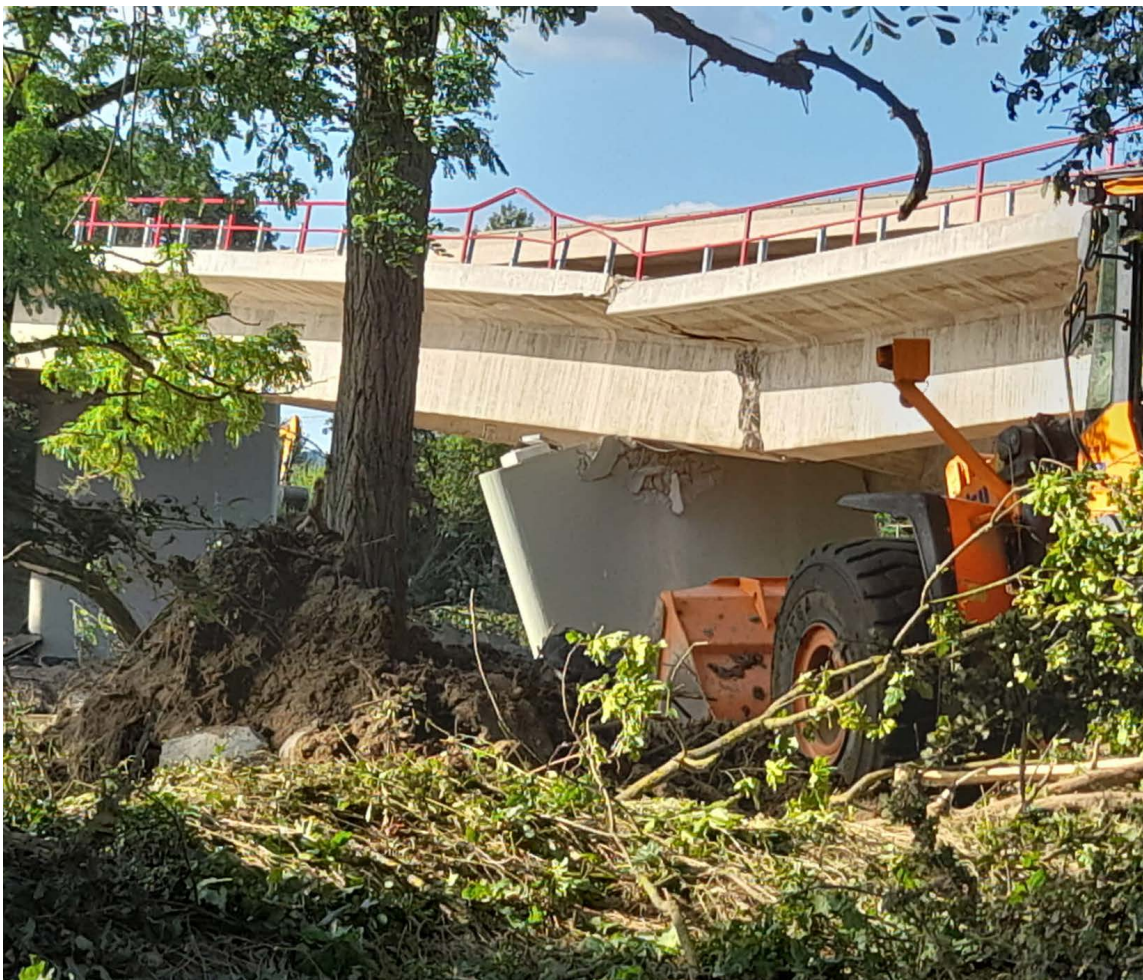
Abb. 11: Zerstörte Brücke in Bad Neuenahr-Ahrweiler (Foto P. Ruland)
