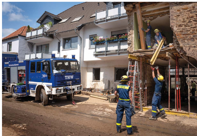
Zahlreiche beschädigte Häuser stützen THW-Einsatzkräfte im Rahmen der Gefahrenabwehr ab. (Foto: THW / Yann Walsdorf)
