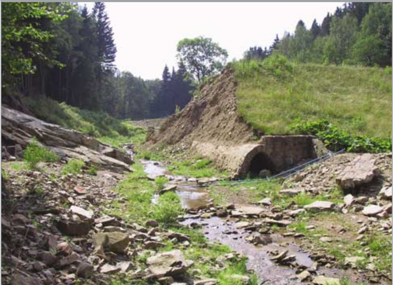
Abb. 4-3: Vom Hochwasser 2002 eingeschnittener Erosionskanal im Damm des Hochwasserrückhaltebeckens oberhalb Glashütte (Foto: S. Schümberg 2003)
